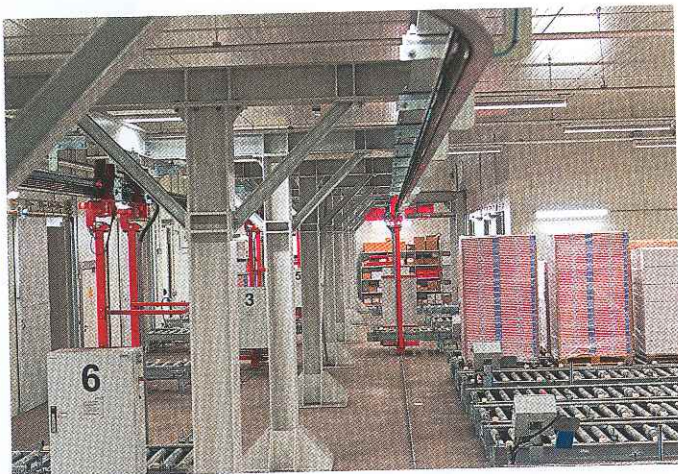
2 Elektrohängebahnen sind hoch skalierbar – Fahrzeuge können bei Lagererweiterungen einfach hinzugekauft oder bei reduziertem Anlagenbetrieb ausgeklinkt werden
